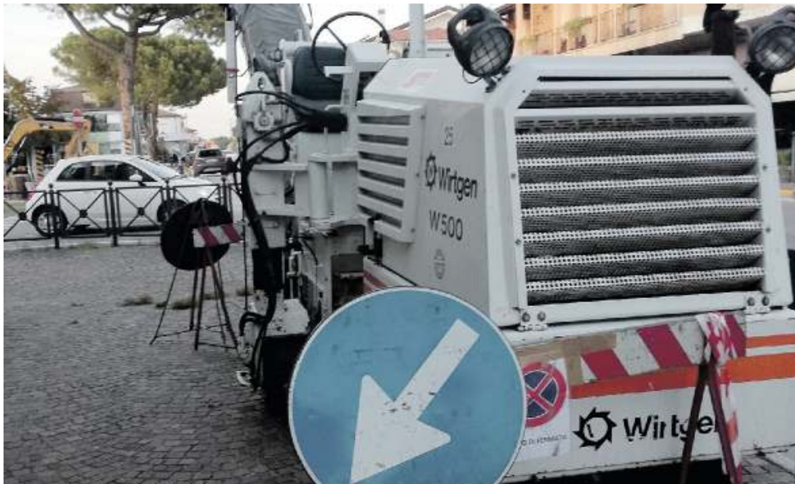
RIQUALIFICAZIONE Partiti i lavori per sistemare le strade disastrose, in azione la macchina che rimuove lo strato usurato
